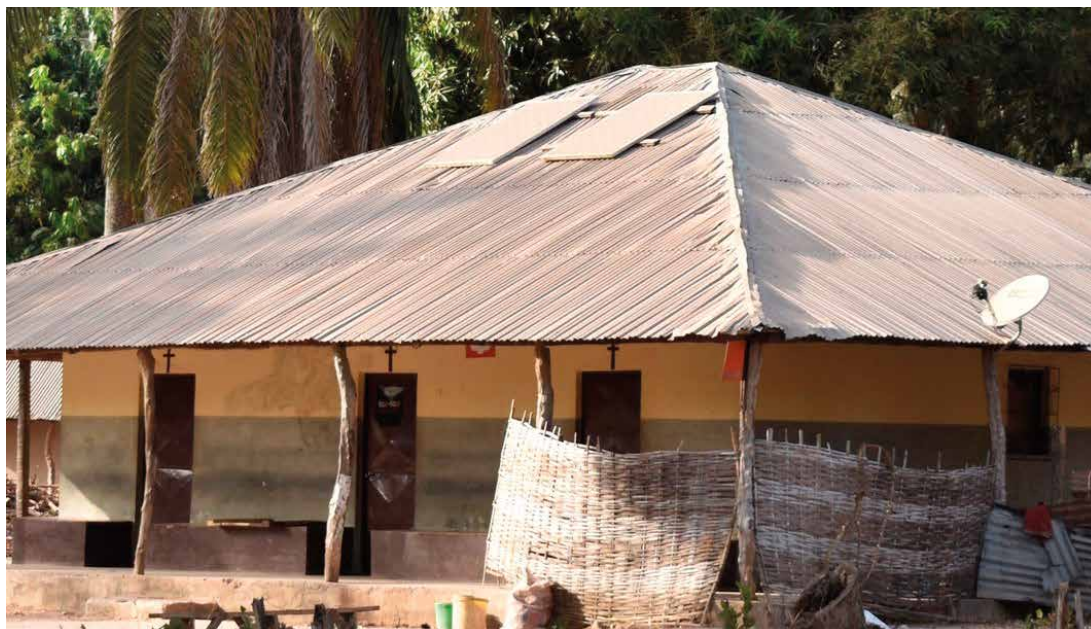
Foto 33 - Painéis solares no telhado de uma casa na periferia da cidade
